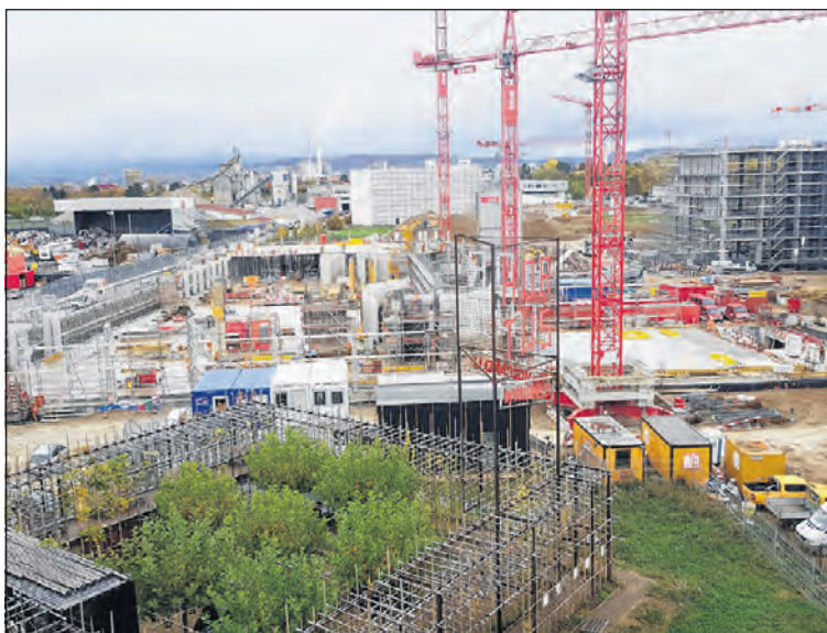
Die Anlage wird künftig ausschliesslich mit erneuerbaren Energien das gesamte Areal mit der benötigten Wärme und Kälte versorgen.
