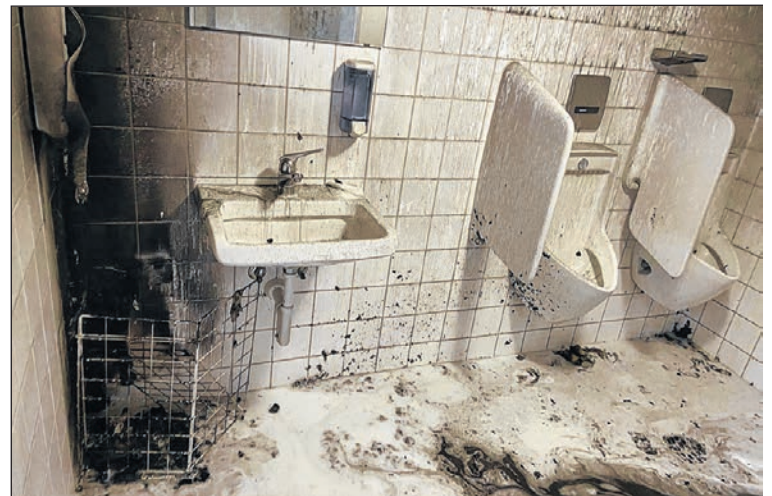
Bei der Brandstiftung am 6. Juli entstand erheblicher Sachschaden. Die WC-Anlage kann derzeit nicht mehr benutzt werden. Foto Polizei BL
