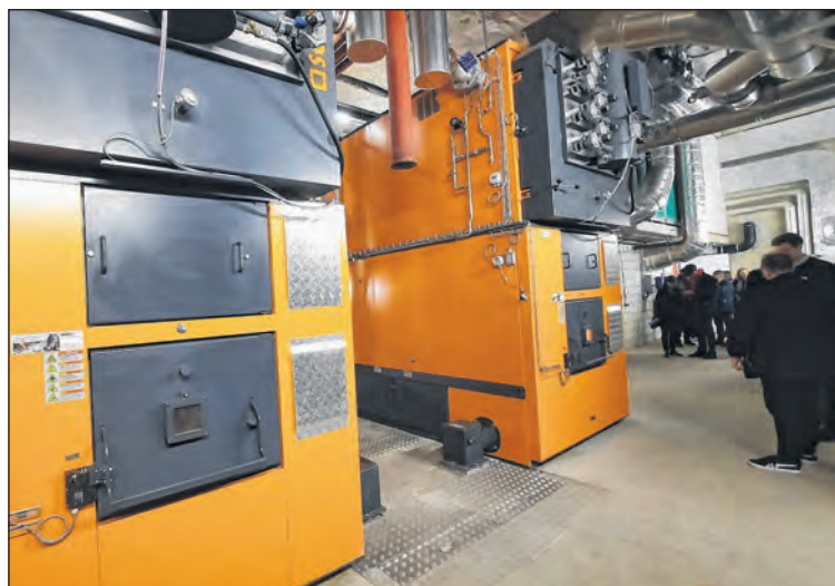
«Wie funktioniert das jetzt genau»? Am Tag der offenen Tür konnte die Bevölkerung in die Wärmezentrale Neuallschwil reinschauen.
