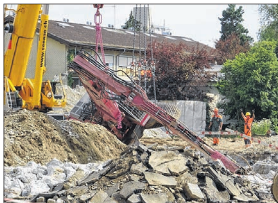
Auf der Bettenacker-Baustelle sank Anfang Juli ein Raupenbagger in einen Hohlraum und musste mit einem Kran geborgen werden.
